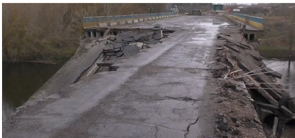
Рисунок 1.11 — Зруйнований міст в селі Бишкінь, Лебединського району
