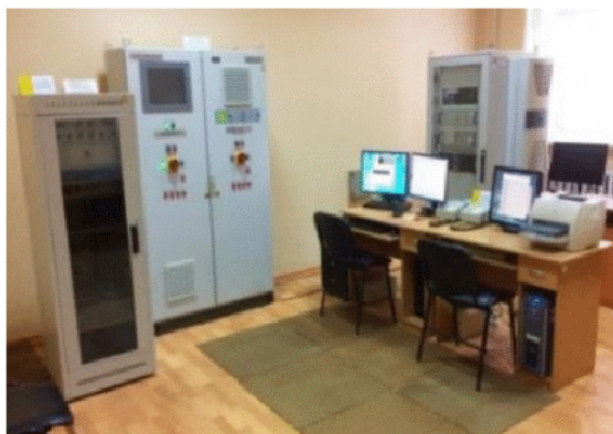
Рис. 1.43 – Зовнішній вигляд апаратного залу станції УНСПІ-8.2 [9]
